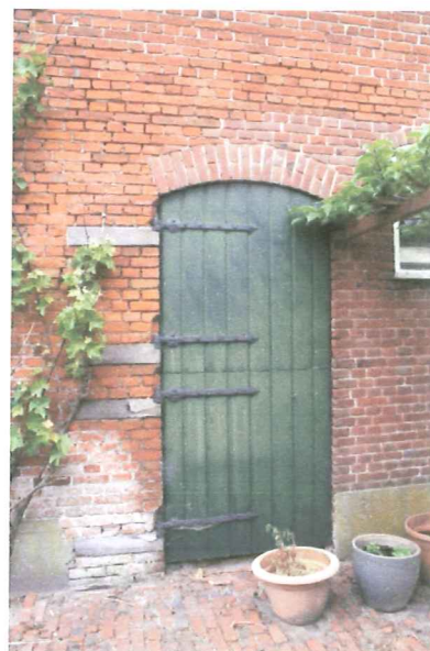
Loopdeur met oud hangwerk
