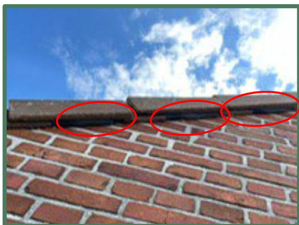
Vulschuim onder de overhangende kopgevelpannen
