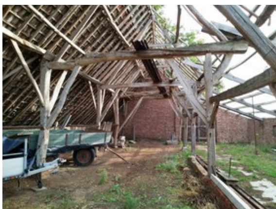
Afbeelding 2: Opstal 1, zwaar beschadigde schuur door stormschade. Foto: V. Stuit | Ecoresult B.V.
