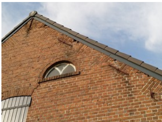
Afbeelding 4: Opstal 3 (berging) op enkele plaatsen kapotte bakstenen en scheuren. Foto: V. Stuit | Ecoresult B.V.
