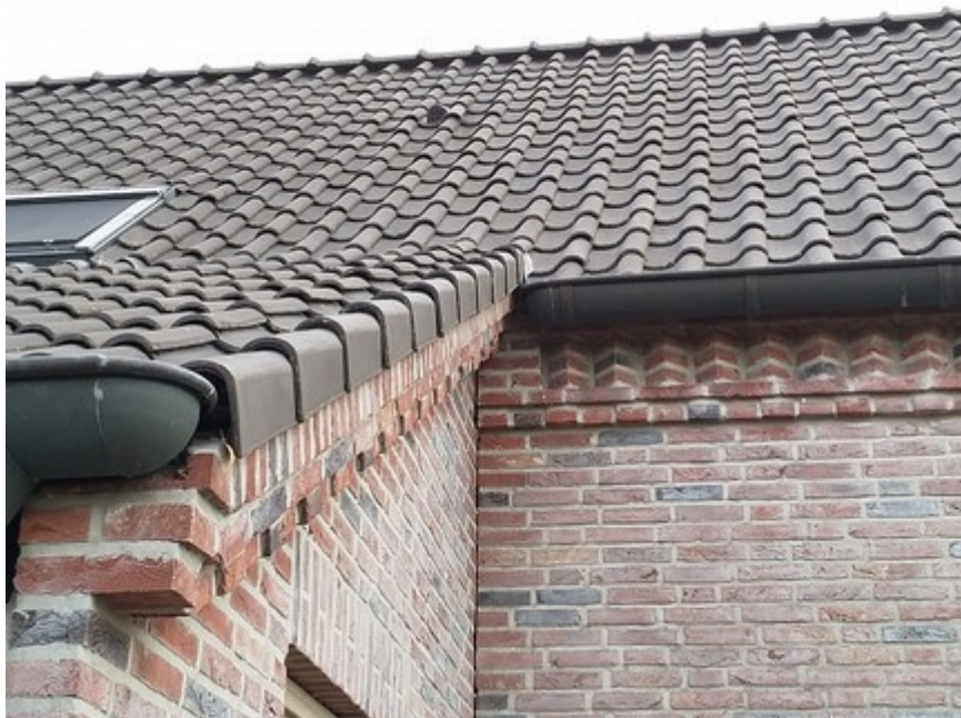
Woonhuis (zuidkant) open dilatatievoeg. Mogelijk geschikt voor vleermuizen. Foto: V. Stuit | Ecoresult B.V.
