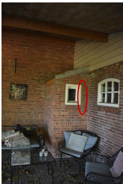
Achtergevel toiletruimte. De sporen in het metselwerk zijn rood omcirkeld.
