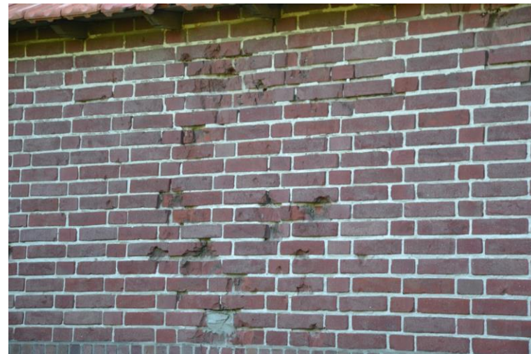
Detail van de oorlogsschade.
