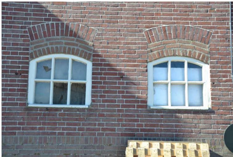
De stalramen met ingeboet metselwerk erboven.
