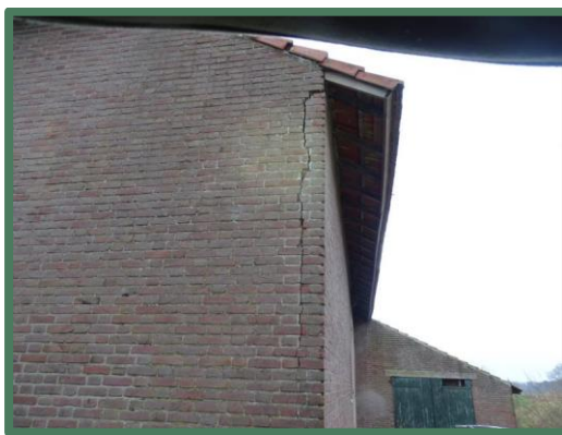
Afbeelding 33: Scheur in de muur
