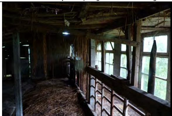
Foto 3. Binnenzijde vervallen schuurtje
