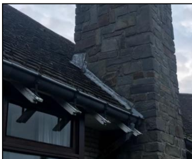
Figuur 5. Recht opstaand lood, geen ruimte voor gierzwaluw.
