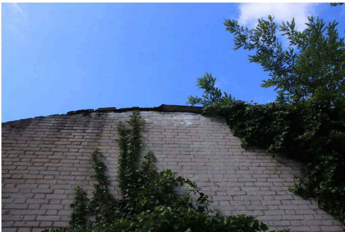
Foto 1: Het gebouw bestaat uit een enkelsteense muur met asbestverdacht dakmateriaal
