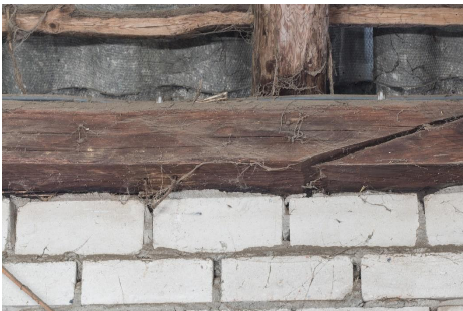
Ondermetselde gebintplaat met las en bij de tweede stootvoeg spijkers van een verdwenen wandstijl of windverband.
