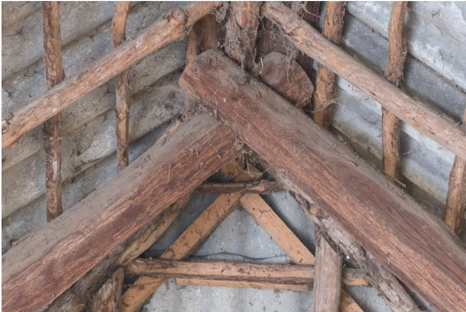
De aansluiting van de beide spantbenen in de nok. De verbinding is hier gebout. In de dakpunt lijkt sprake te zijn van een stukje vernieuwing in vurenhout. Mogelijk heeft hier oorspronkelijk een stiepel of iets dergelijks gezeten.
