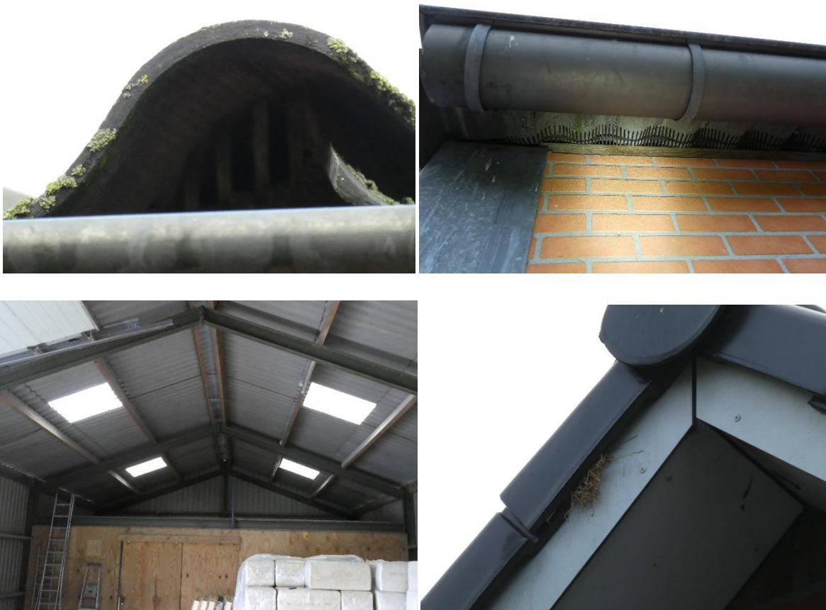
Afbeelding 13 t/m 16: vogelschroot, afwezigheid dakbeschot en nest huismus onder dak bestaande te behouden woning. Bron: BNL advies. Datum: 1-12-2022
