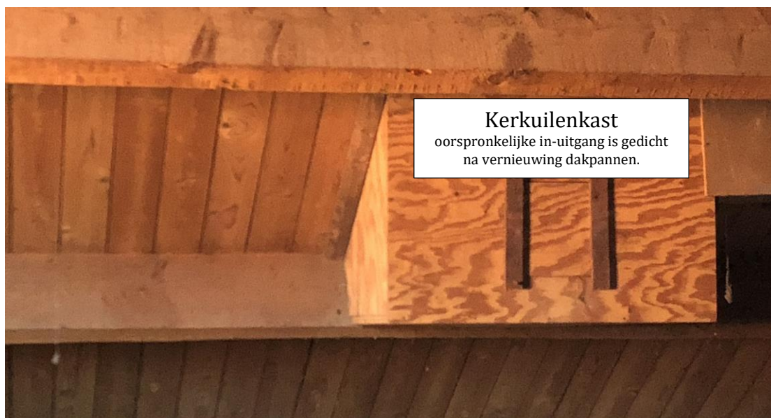
Figuur 20: Kerkuilenkast op noordelijke zolder (locatie 3b in figuur 3). Toegang tot de kast is een aantal jaren geleden afgesloten als gevolg van het aanbrengen van een nieuw pannendak.
