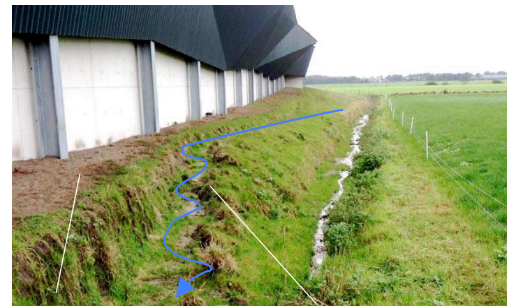
regenschaduw en erosie door afstromend water
