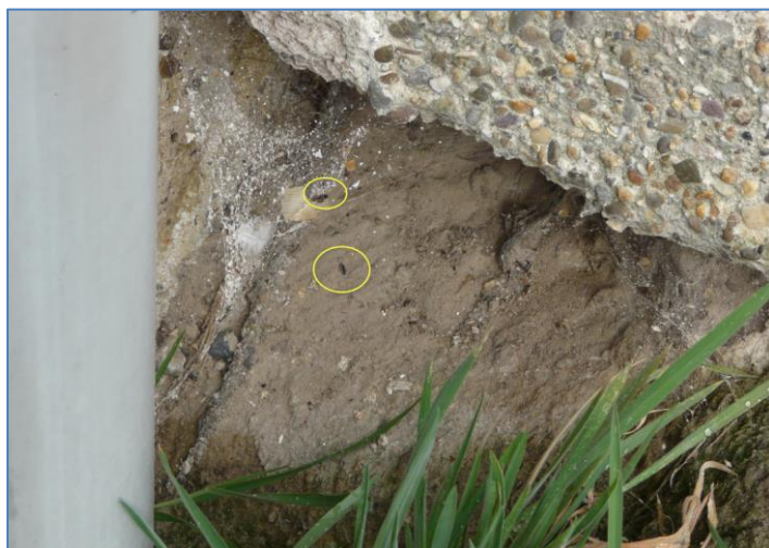
Foto 19 uitwerpselen huisspitsmuis bij opening betonvloer
