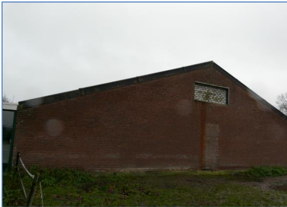
Foto 12 dichte aansluiting daklijst kopgevel gebouw 9
