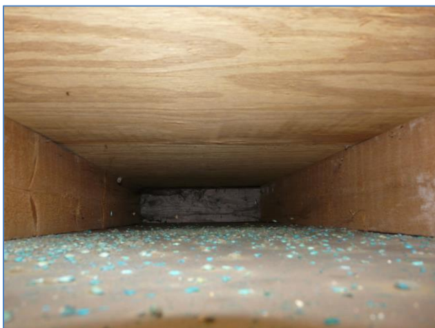
Foto 14 'Schone' tussenruimte plafond en dakbedekking
