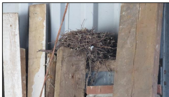
Foto 10. Nest in gebouw 5
