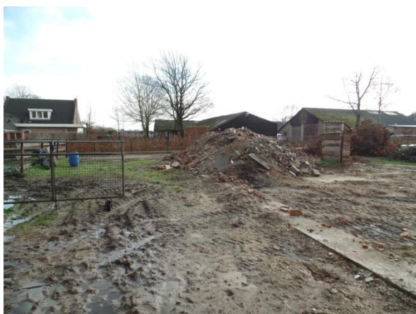
Fig.4 Puinhopen en fundament Laarbroek 9
