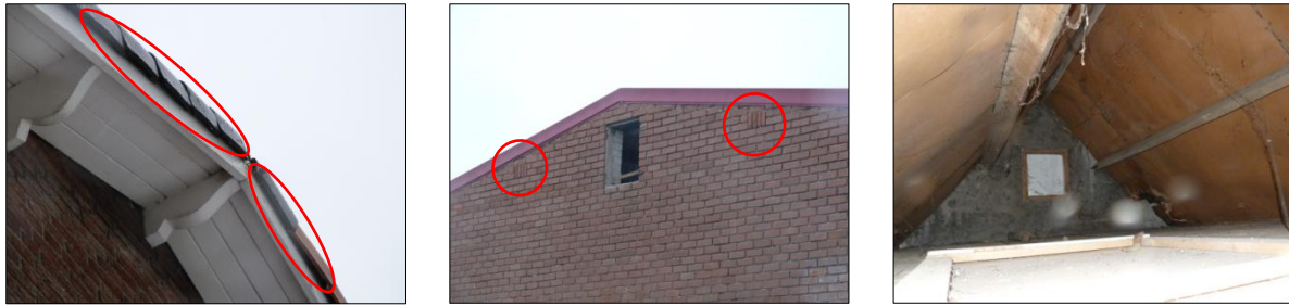
Figuur 9 t/m 11. V.l.n.r. dakrand van de woning, open stootvoegen van loods en zolder van het schuurtje.
