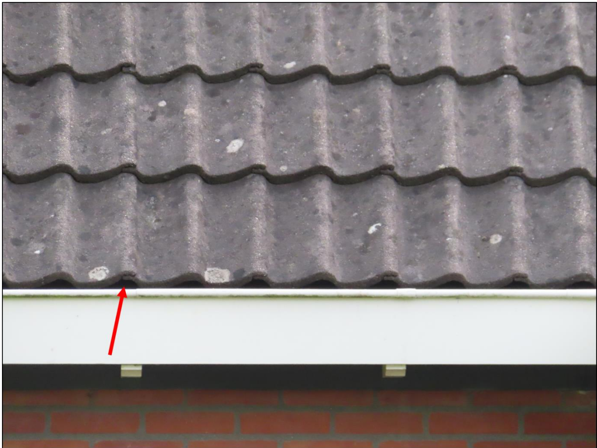
Figuur 2. Onder de gegolfde dakpannen van een naastgelegen woning is nestgelegenheid voor huismussen aangetroffen.
