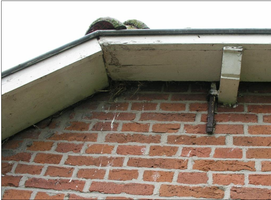
Figuur 3. Nestmateriaal onderzijde dakgoot [bron: BügelHajema Adviseurs, 2015]
