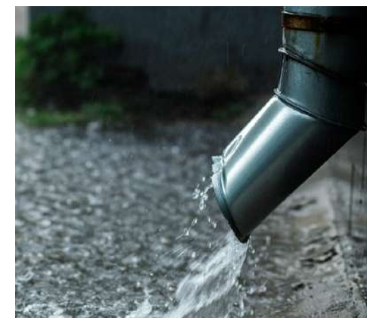
Bovengrondse afvoer van regenwater
