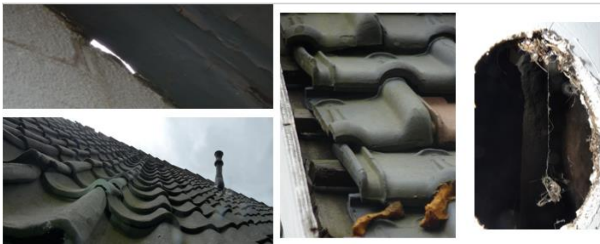
Figuur 5.4 Linksboven een voorbeeld van de gaten in de gevel die doorlopen, Linksonder en in het midden losliggende dakpannen waar tocht en regen naar binnen kunnen. Rechts het gat in het dak va binnenuit waar duidelijk veel tocht voelbaar was.
