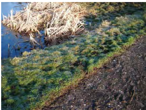
3. geen (asbestplaat) beschoeiing
