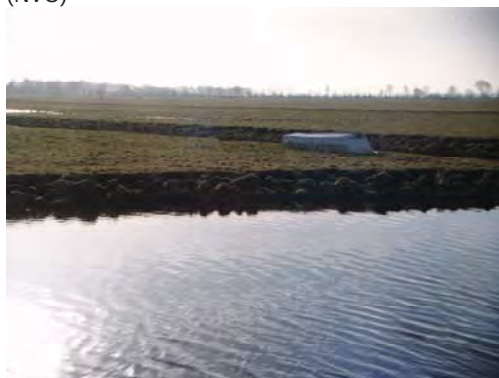
16. geen (asbestplaat)beschoeiing aanwezig
