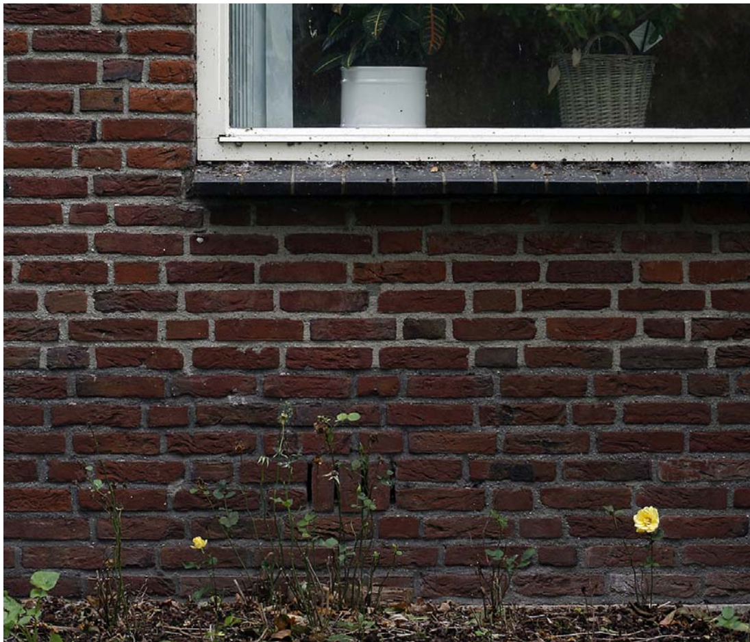
Afb.8: Spouwvoegen zitten te laag voor vleermuizen
