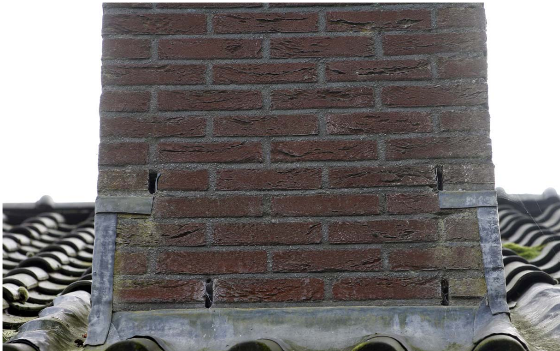
Afb.2: Detail van de loodflappen en spouwvoegen vol rag op de schoorsteen
