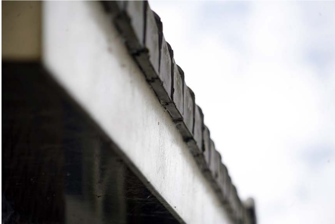
Afb.6: Dakpannen sluiten strak aan op daklijst
