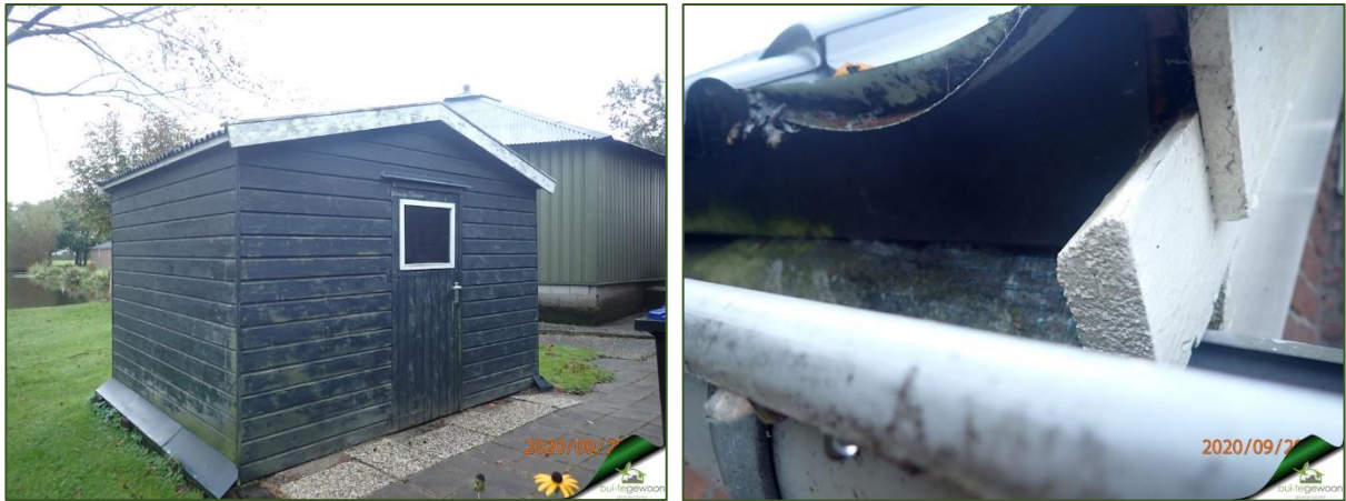
Figuur 8. Opstal 2, schuur bij tweede bedrijfswoning (rechts afdichting golfplaten dak)
