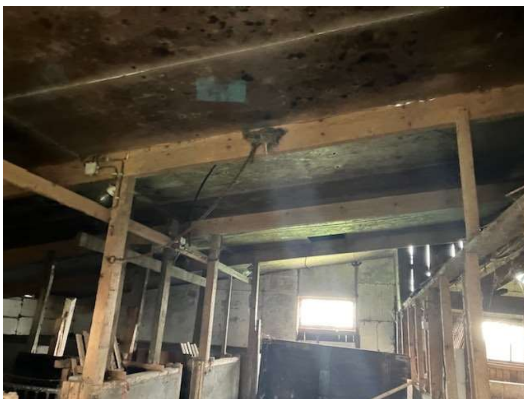
• Afbeelding 6: Houten oude schapenstal, staat al enkele jaren leeg met verlaten boerenzwaluwnesten
