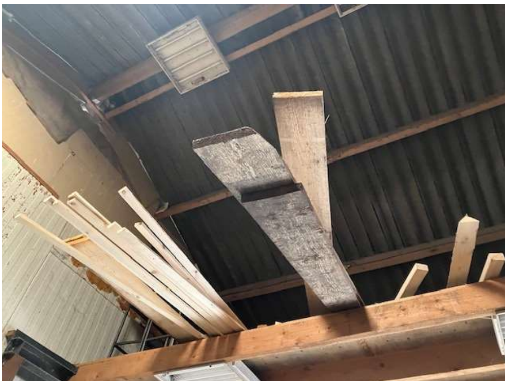
• Afbeelding 13: Binnenzijde tweede damwand schuur, dak ongeïsoleerd
