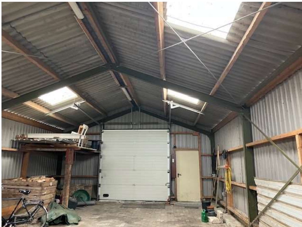
• Afbeelding 10: Binnenzijde schuur, gevels en dak ongeïsoleerd
