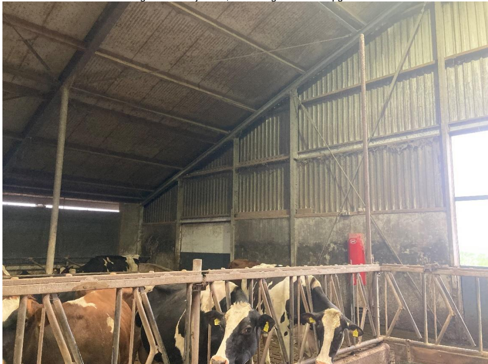
• Afbeelding 3: Binnenzijde stal, met niet geïsoleerde topgevels
