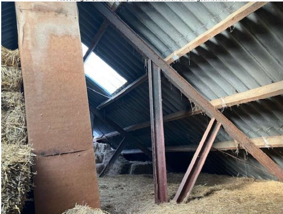
• Afbeelding 8: Constructie kap van de verbouwen schuur geen isolatie
