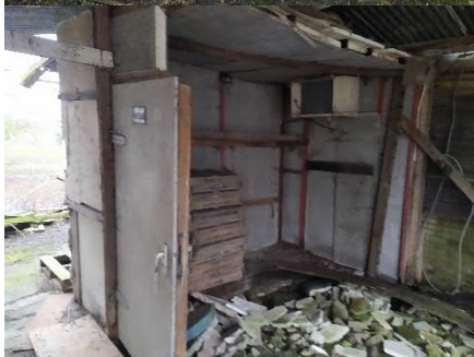
9. Schuren achter op het perceel zijn ook verlaten. Hier zijn onder andere koelcellen, asbestverdacht golfplaten dakbedekking, basin, puin, apparaten en piepschuim waargenomen.
