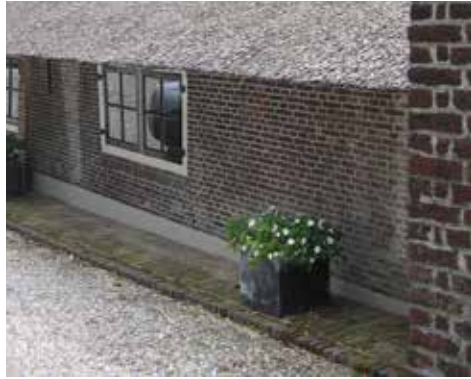
Afwijkende verharding tegen de gevel.
