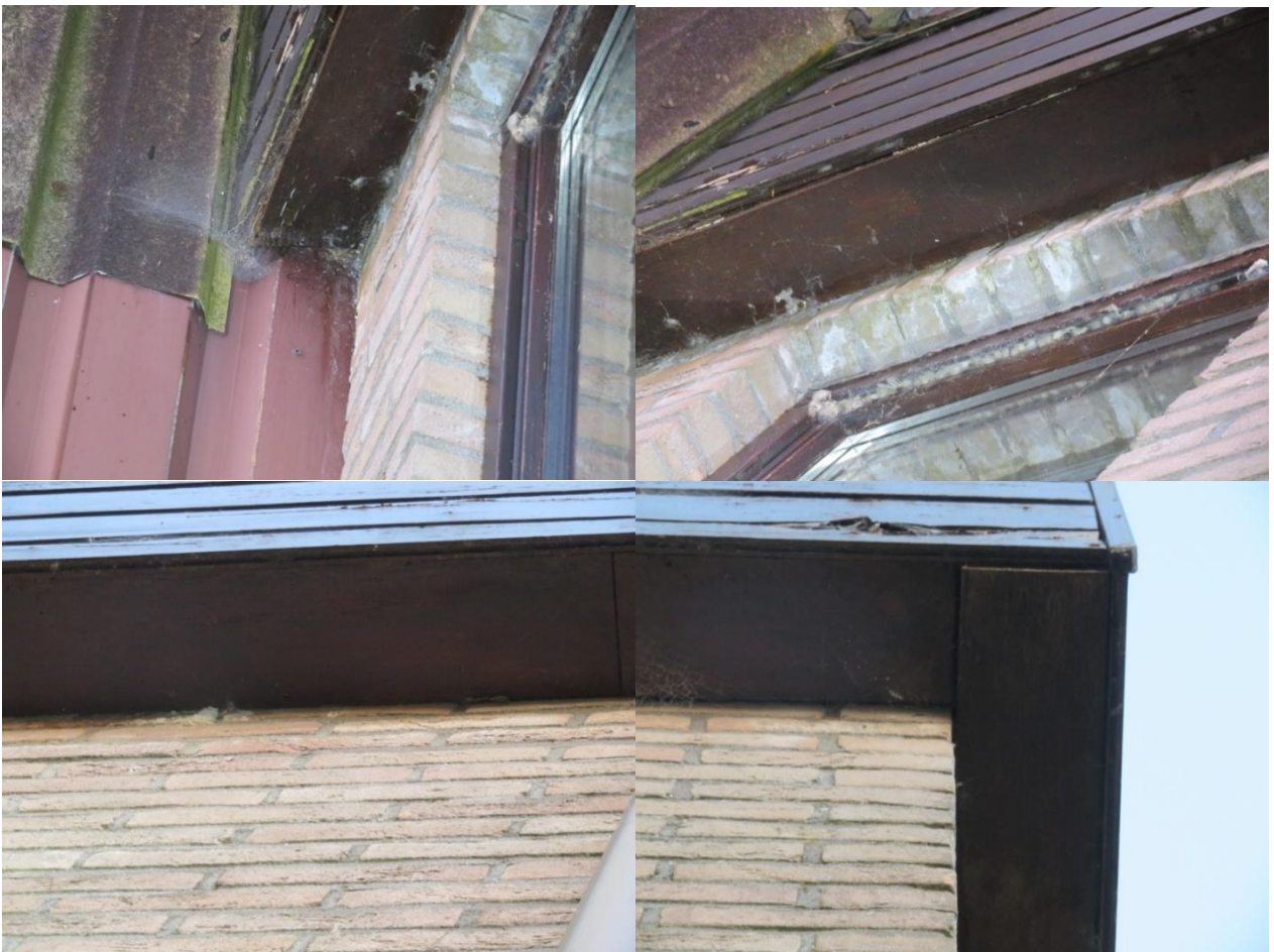
Afbeelding 4: Detailfoto's van de aansluiting van betreffende gevel op sporthal, daklijst en kozijn. Er zijn geen invliegopeningen voor vleermuizen aanwezig.
