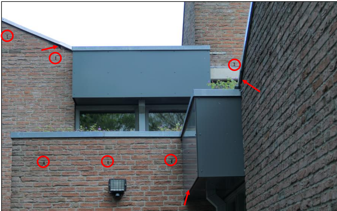
Figuur 4.10 Open stootvoegen zijn rood omcirkeld, ruimtes onder daktrim en houten gevelbetimmering zijn aangegeven met rode pijl.
