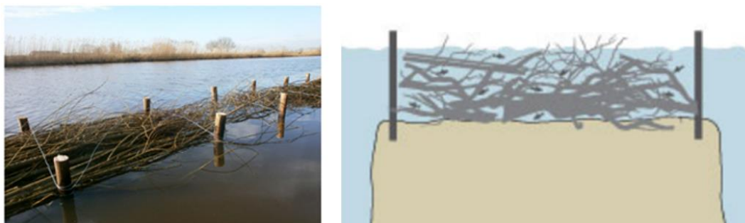
Figuur 4-1: Voorbeelden van vissenbossen op verzonken legakkers. Beide figuren zijn afkomstig uit Van Helsdingen & Buizer, 2018. Links is een foto van een vissenbos (figuur 4.9 uit voorgenoemde rapport). Rechts geeft een schematische dwarsdoorsnede (Kos, 2022).
