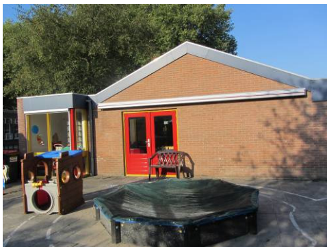
Figuur 11. Links: Hoekdak van 'De Kinderkamer'. Rechts: Smalle ruimte achter de afwerking van een dakrand.
