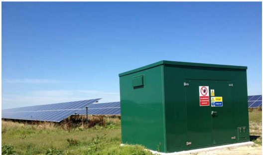
Referentiebeeld - Klant onderstation
