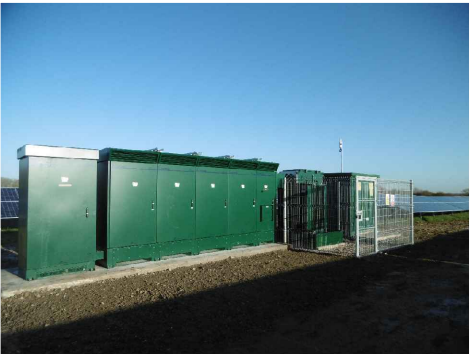
Referentiebeeld - v.l.n.r. Omvormer, Transformator en Switchgear
