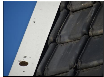
Figuur 8. Ruimte tussen de daklijst en dakpannen bij de woning op de onderzoekslocatie.
