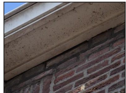
Figuur 11. Ruimten tussen het boei-boord en gevel bij de bebouwing op de onderzoekslocatie.
