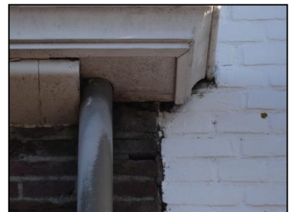
Figuur 14. Ruimte tussen het boei-boord en de gevel bij de bebouwing op de onderzoekslocatie.
