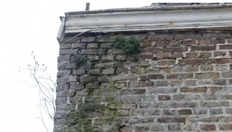
Enkele van de muurvarens op de zijgevel van de boerenwoning.
