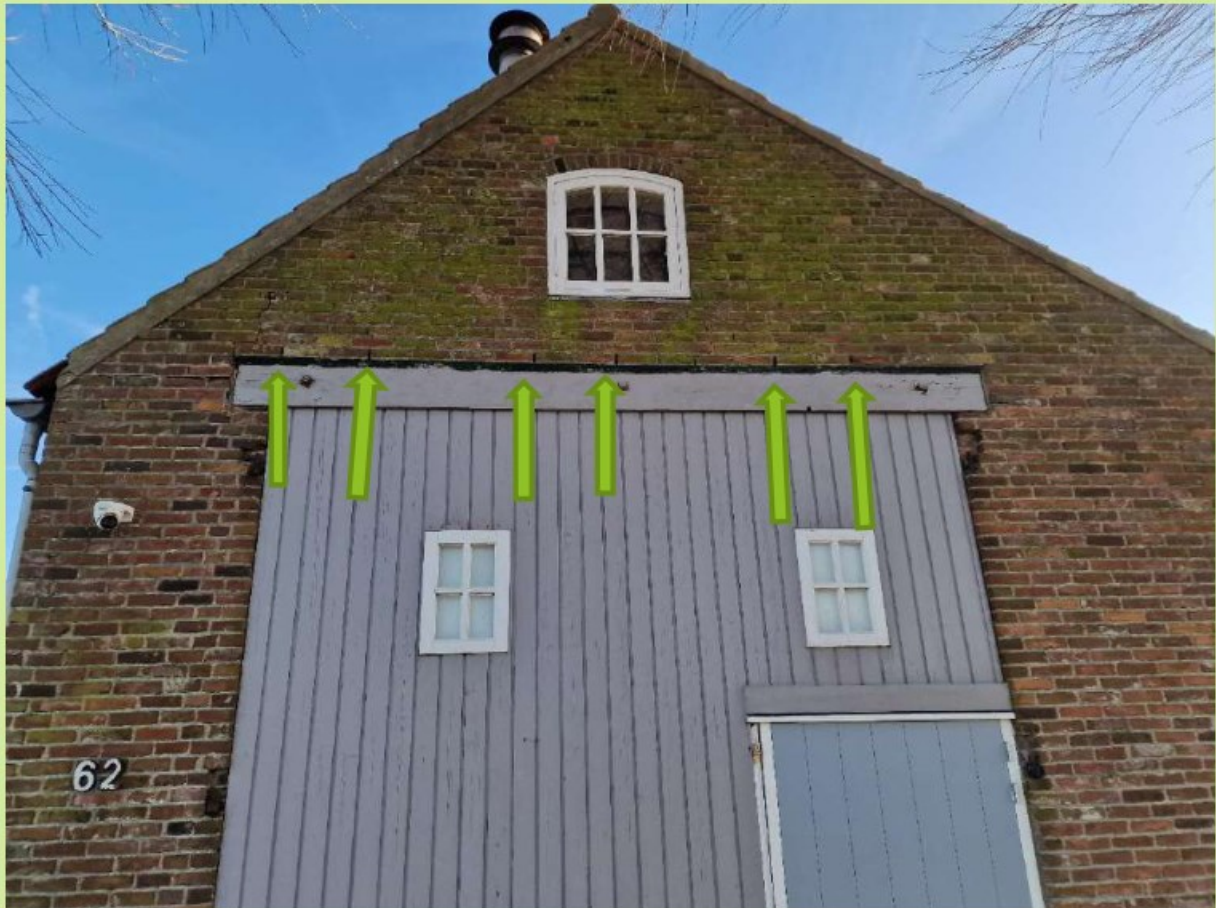
Figuur 8. Detailopname zijkant woning. De groene pijlen wijzen de open stootvoegen aan.
