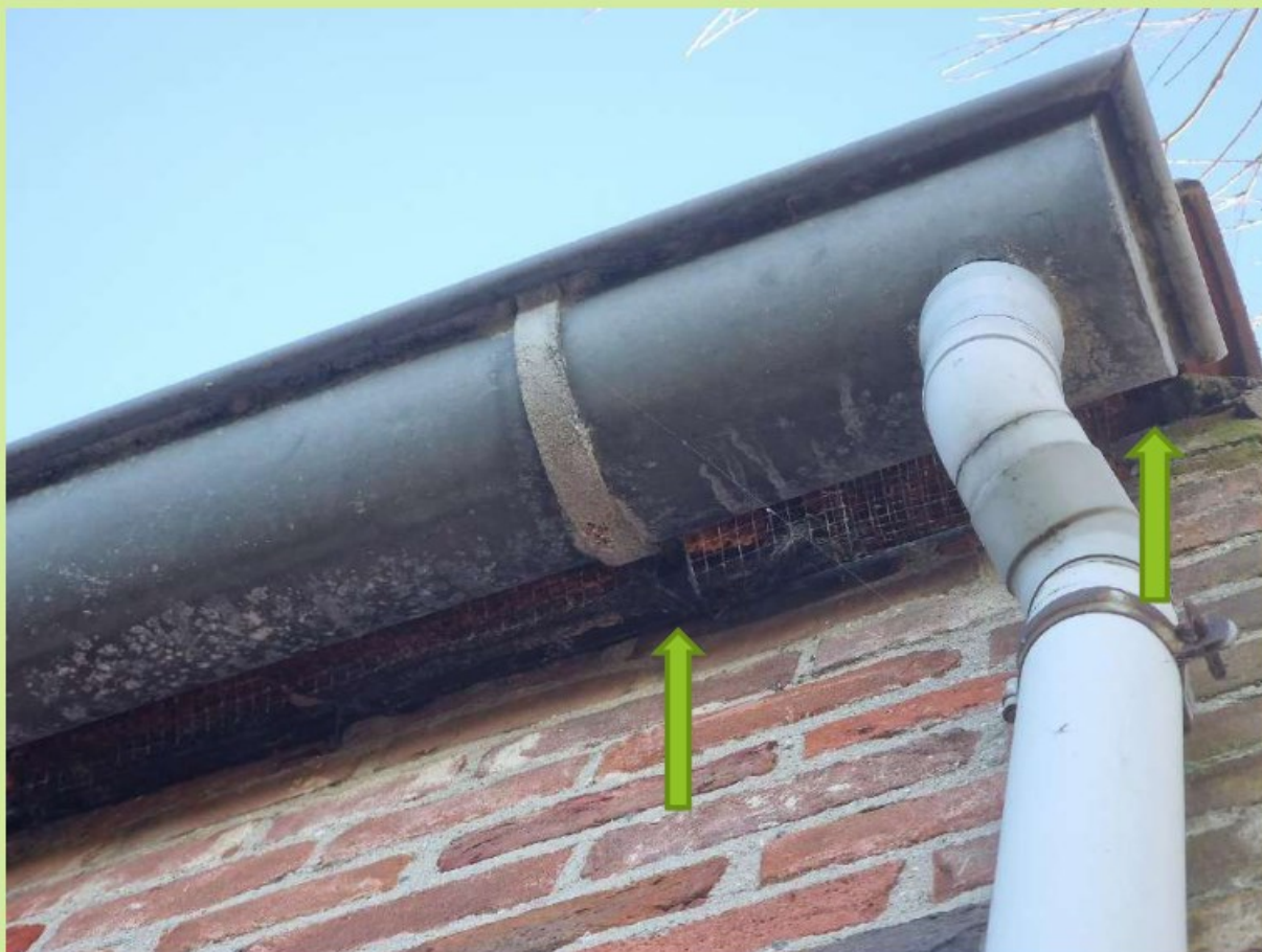
Figuur 7. detail dakgoot voorzijde. Onder de goot is gaas aangebracht, hier zitten openingen tussen.
