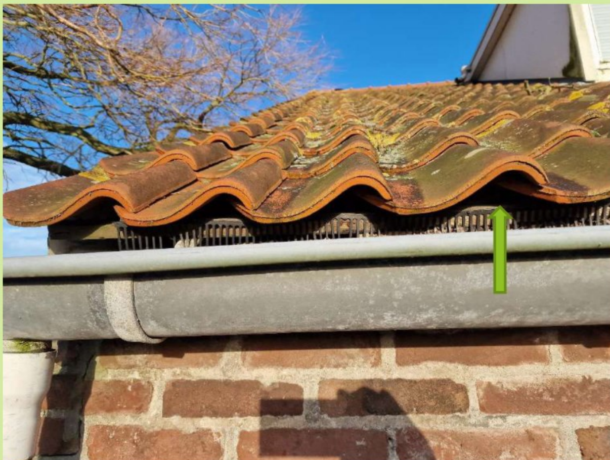
Figuur 9. Detailfoto dakgoot achterzijde. Onder de dakpannen zijn openingen zichtbaar.
