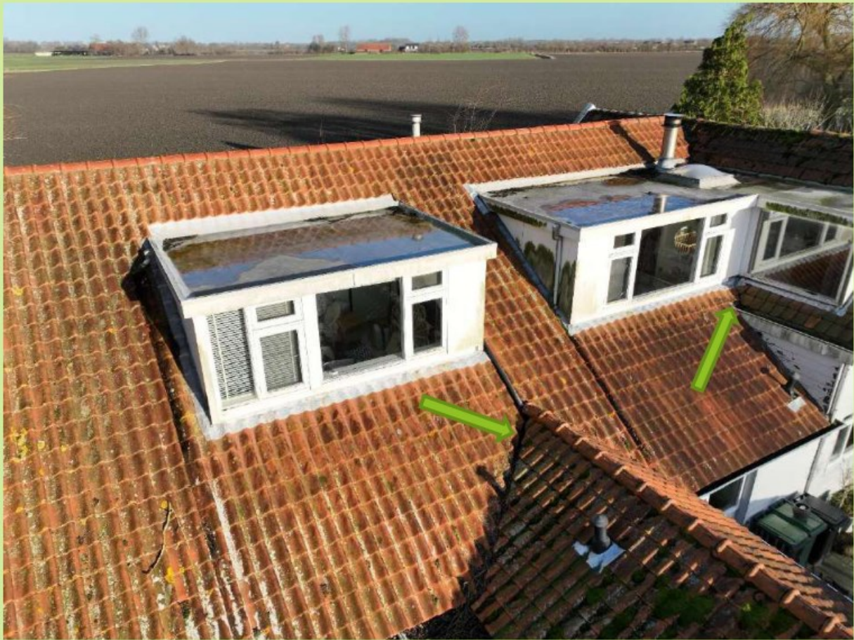
Figuur 13. pannendak vanaf boven gezien. Op diverse plekken zijn openingen te zien.
