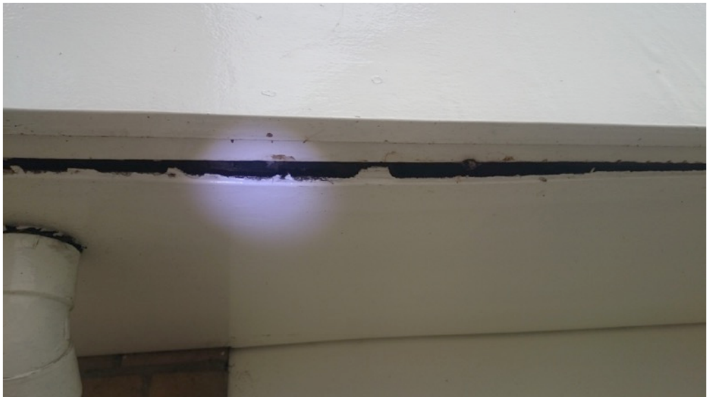
Figuur 4 In de boeiboorden van de fysiotherapeut/kinderdagverblijf zijn flinke kieren aanwezig welke toegang verlenen tot een ruimte in het dak. Deze ruimte en de kieren zelf zijn te groot waardoor er geen sprake is van een gunstig microklimaat voor potentiële rust- of verblijfplaatsen voor vleermuizen.
