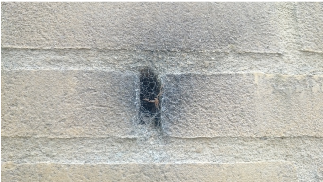
Figuur 2 De stootvoegen in de muren aan de zijkant van de supermarkt zijn allen bedekt met spinrag, wat duidt op de afwezigheid van vleermuizen.
