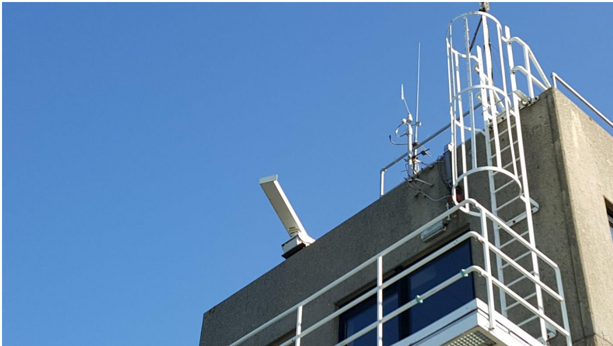
Figuur 2: Radar op het bedieningsgebouw van de sluis
