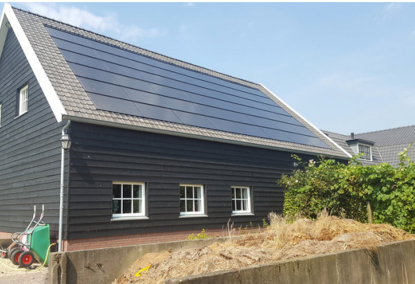
Zonnepanelen in een pannendak ▲
