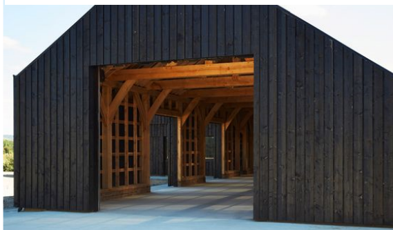
Grote sparingen t.p.v. de kopgevels
