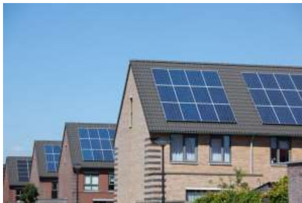
Afbeelding 3.8 Vrije ruimte tussen PV-panelen (Bron: Shutterstock)
