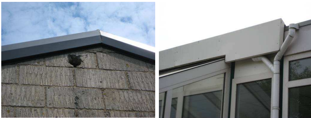
Afbeelding 5.1.: Een gat (links) en betimmeringen (rechts) in het bedrijfspand.
