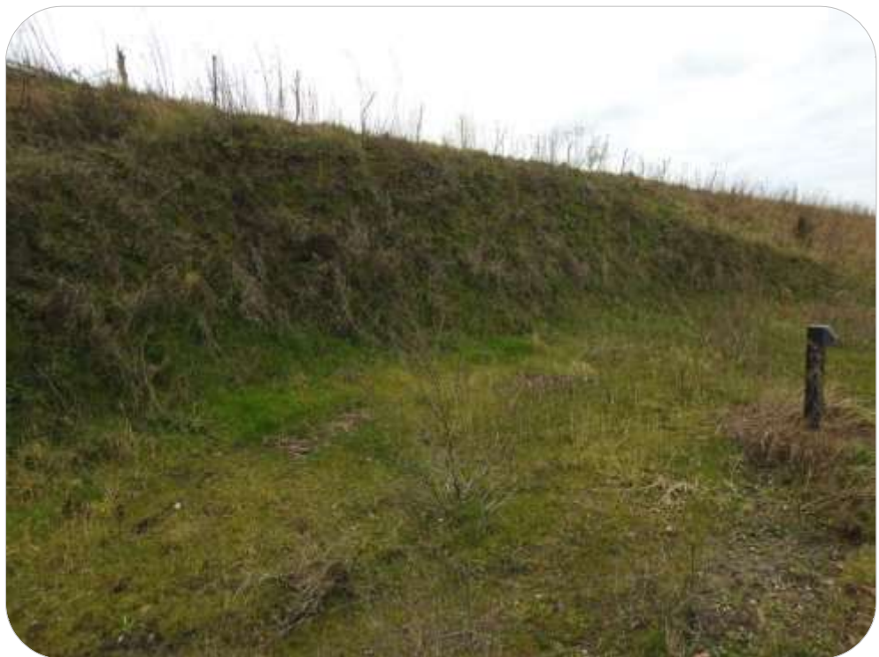
Afbeelding 9, Overwegend afgestorven beplanting op de geluidswal, vanaf de weg gezien.
