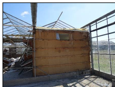
Figuur 9. Kleine verharde kas met kapot dak en daarin een schuur met ruimtes in de muren en het plafond (2 in figuur 3).
