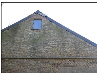
Figuur 25. Gebouw met spleten, gaten en ruimte onder dakrand (7 in figuur 3).
