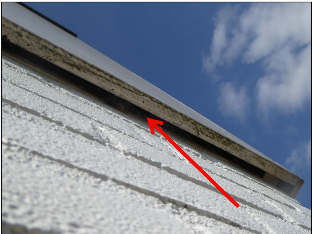
Op meerdere plekken zijn kieren tussen de bakstenen muren en de afwerking van het dak aanwezig. Deze vormen geschikte invliegopeningen voor vleermuizen.
