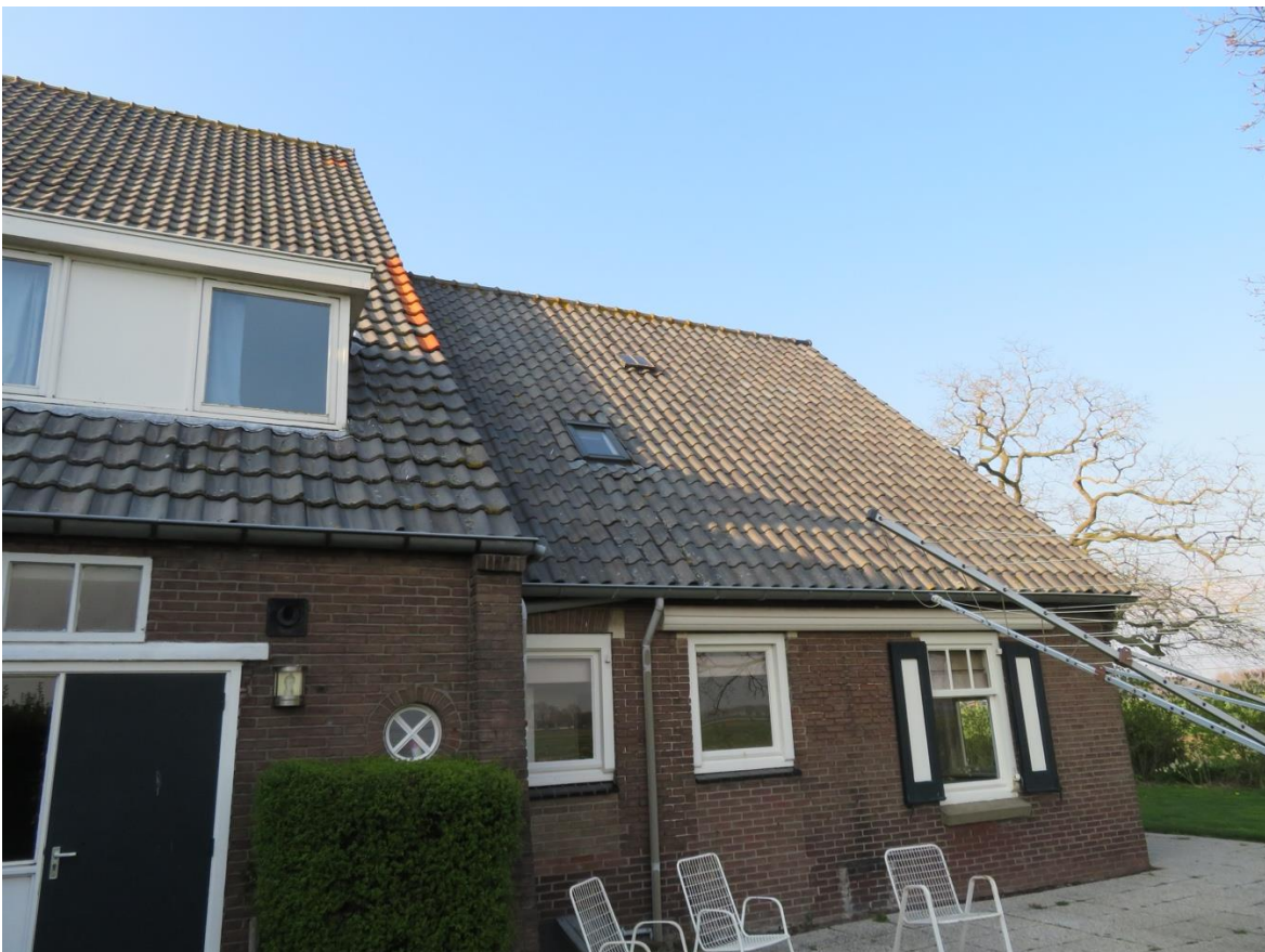
Goed sluitende pannen op het dakvlak
