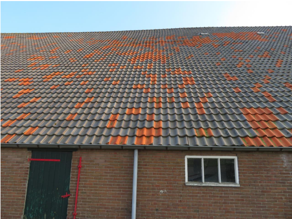
Goed sluitende pannen op het dakvlak
