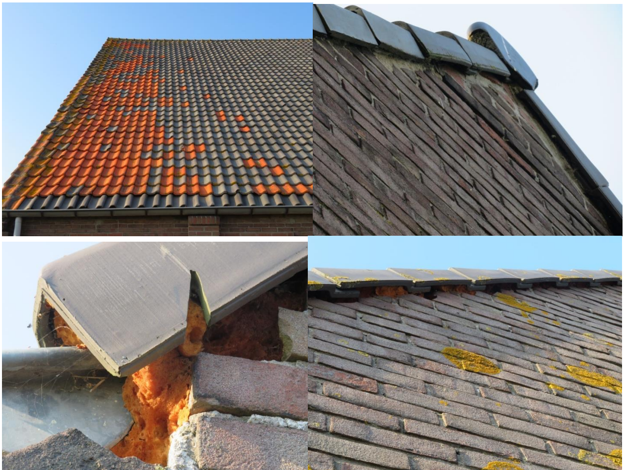
Afbeelding 4: goed sluitende pannen, gemetselde nok- en kantpannen en purschuim tussen goot, pannen en gevel.
