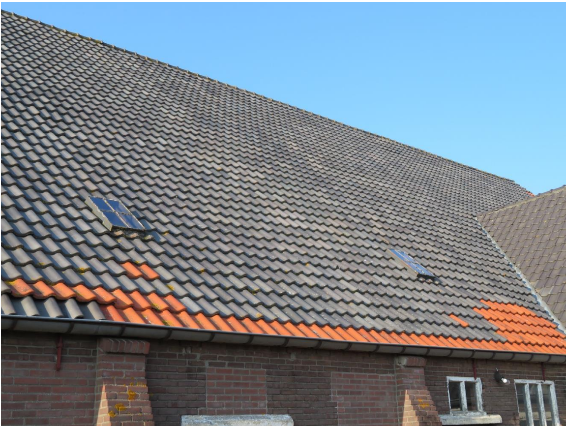
Goed sluitende pannen op het dakvlak
