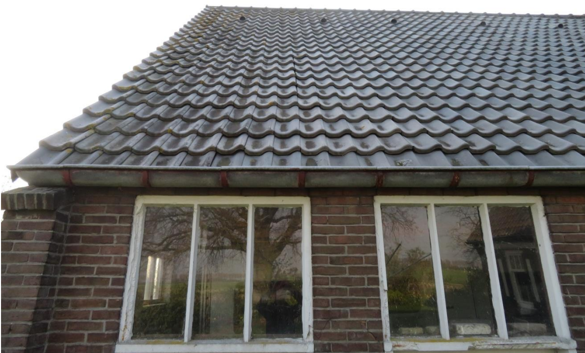
Goed sluitende pannen op het dakvlak
