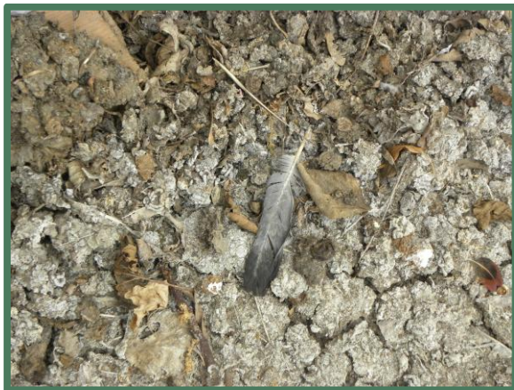
Foto 29: Sporen van duiven onder het nest in de zuidelijke loods.
