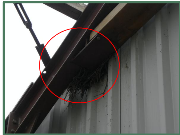
Foto 28: Nest op spant (zuidelijke loods).
