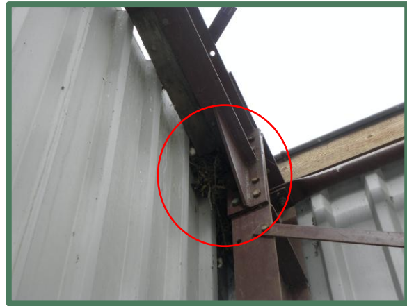
Foto 26: Nest op spant (zuidelijke loods).
