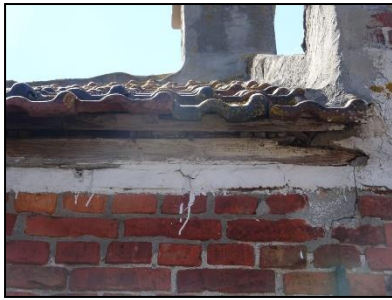
Figuur 24. Spleet onder de dakrand.
